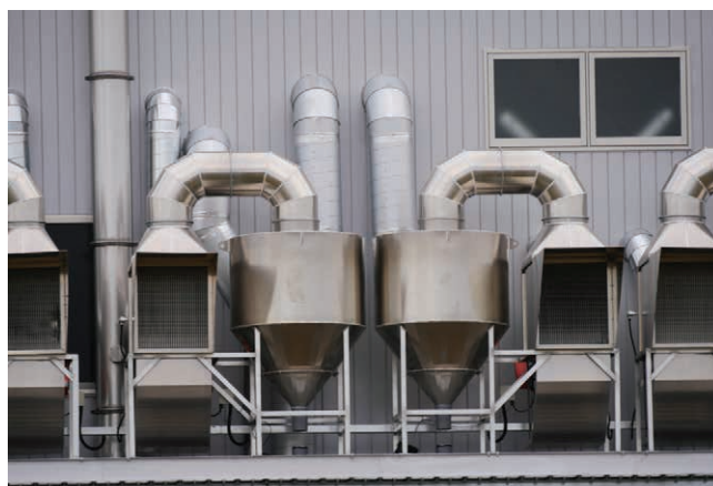
▲乾燥機のリントをサイクロン方式で効率良く集めることができるうえに、大気中に放出されていた排風の熱を回収する最新の省エネ装置
